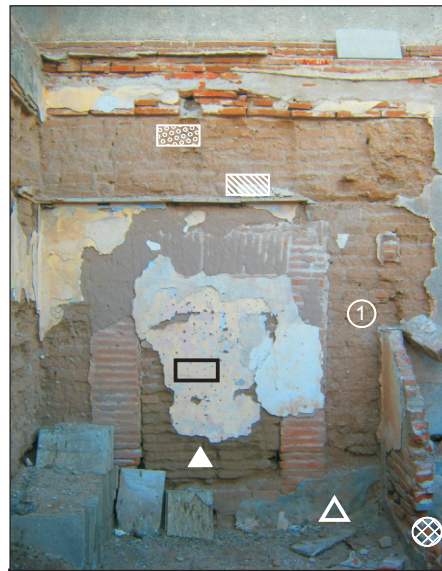
FOTO 3.- MURO AL ORIENTE
