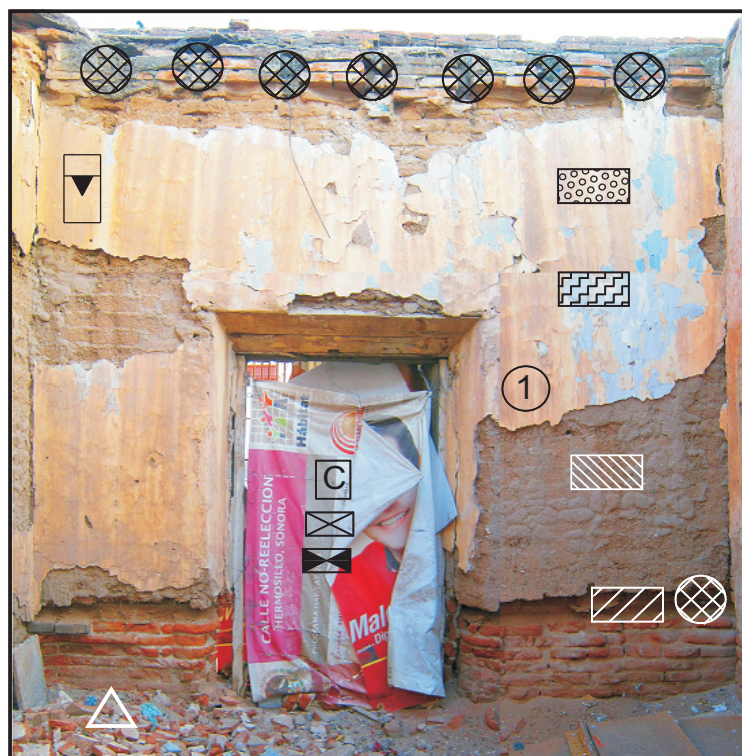
FOTO 4.- MURO AL SUR DE LA COCINA, PUERTA VENTANA INEXISTENTE.
