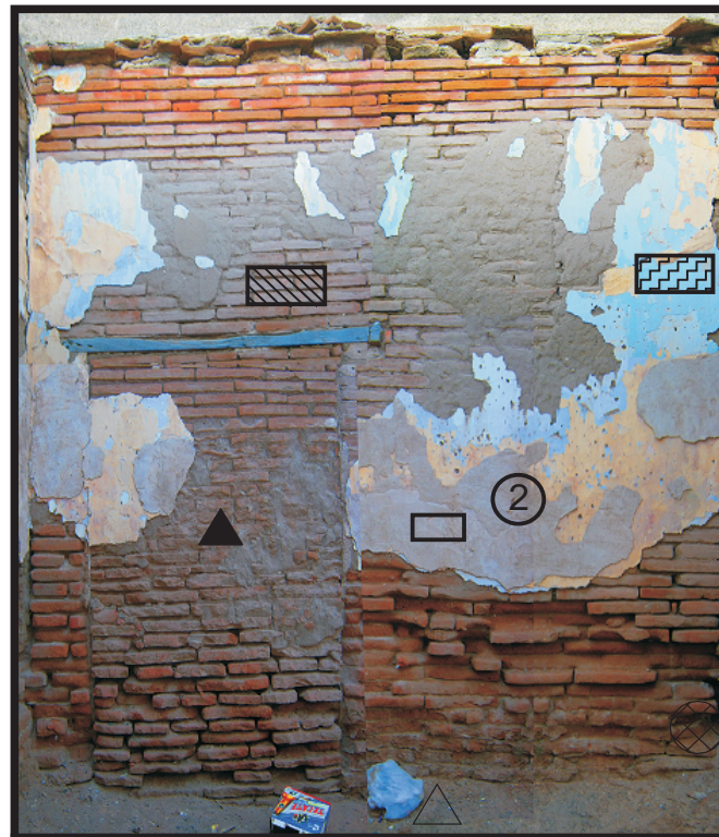
FOTO 1.- MURO AL PONIENTE DEL ZAGÚAN. ACCESO CANCELADO.
