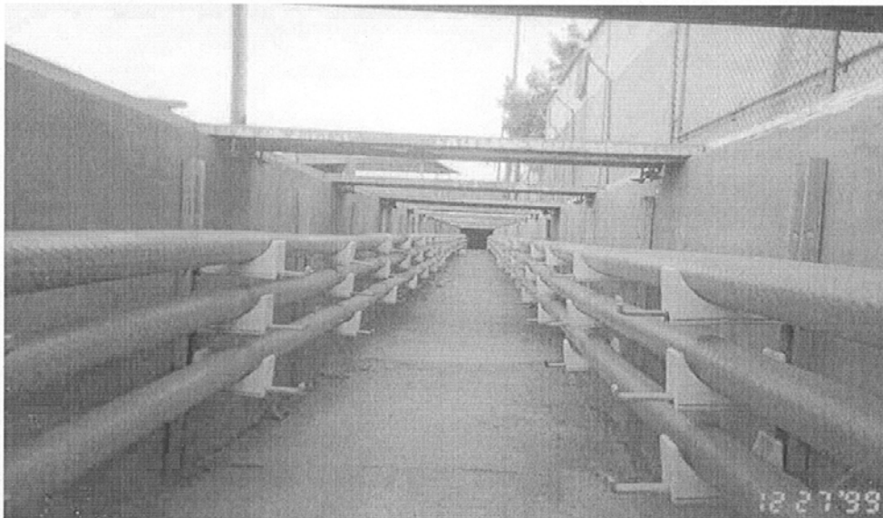
Foto 6.3 Trinchera de concreto armado en interior de la Subestación, para el cableado del cable de potencia
